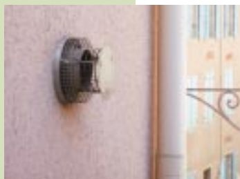
Ventouse de chaudière
