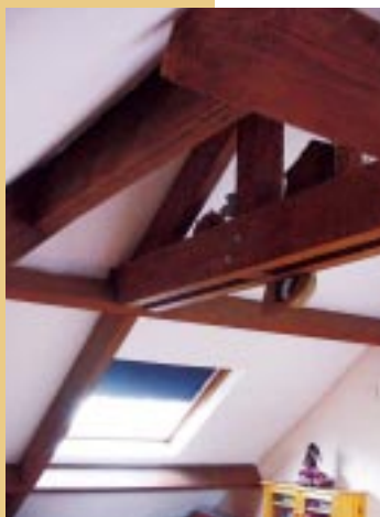
Éclairage des combles
