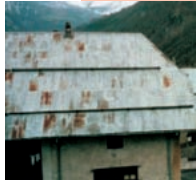
Couverture en acier corrodée
