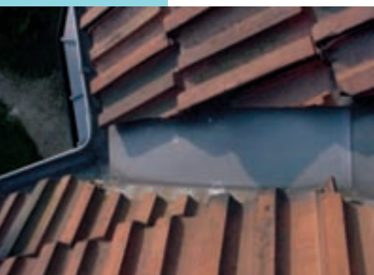
Noue en zinc
