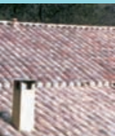
Couverture tuiles canal
