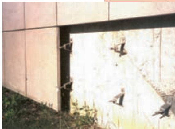
Pierres attachées cassées suite à un choc
